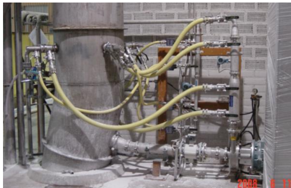
Injection du lait de chaux
